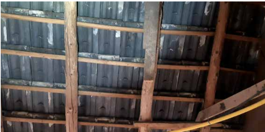
Geen dakbeschot aanwezig onder de dakpannen.
